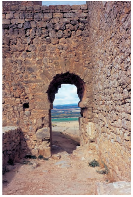
Puerta de escape de fábrica califal en la parte norte del alcázar en la fortaleza califal.
