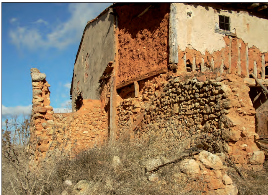
En La Ventosa las majadas de antaño se han derrumbado.
