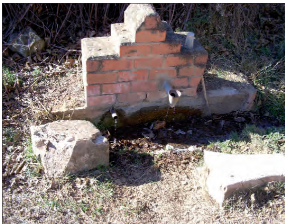
La fuente antigua, de amplio pilón para abreviar a los animales, fue sustituida por esta fuente "de ocasión". Se pueden ver restos de la antigua fuente en este lugar hoy desolado, antes concurrido y muy cuidado.
