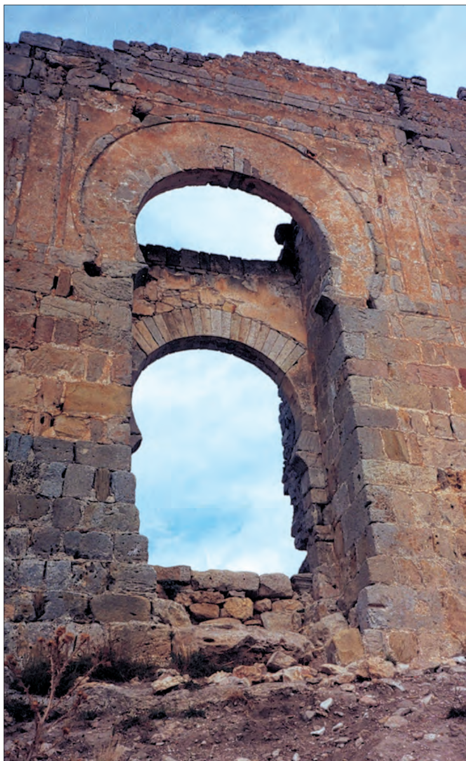
Puertas principales superpuestas de la fortaleza califal en el oeste del albacar vistas desde la parte exterior del castillo, con arco de herradura en la puerta exterior defendida desde la almena. La segunda puerta, en el interior, tenía su defensa desde el hueco en su parte alta.
